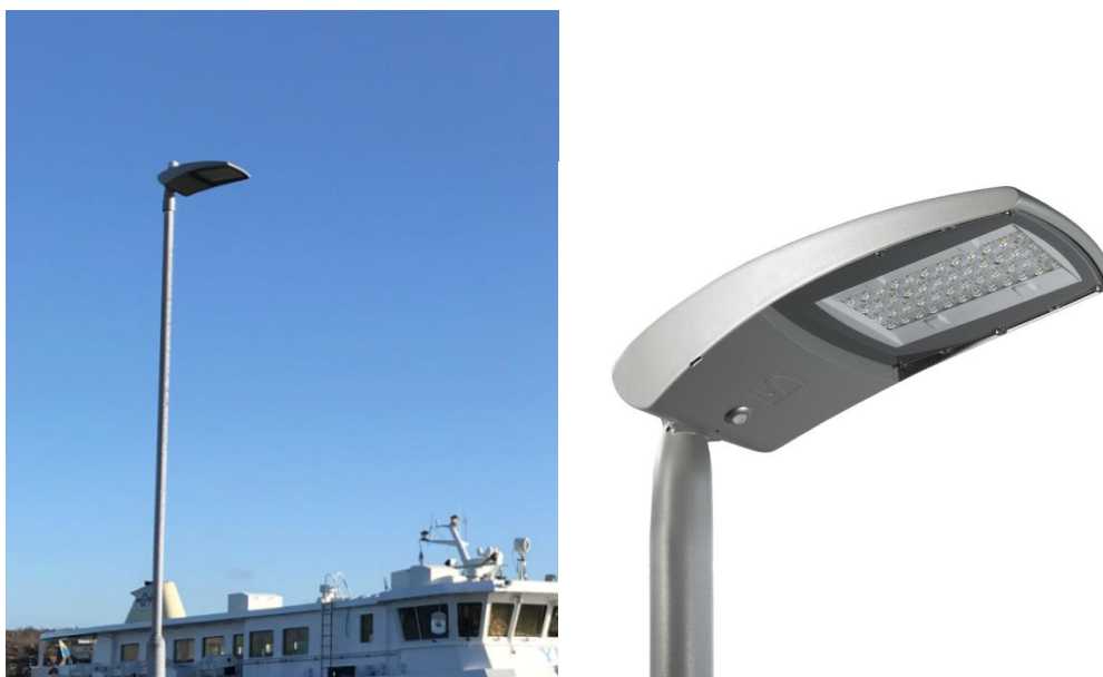
Figur 8. Till vänster: Befintlig stolpe med armatur vid kajen (Bildkälla: COWI AB). Till höger: Produktbild av armaturen Schröder TECEO.
